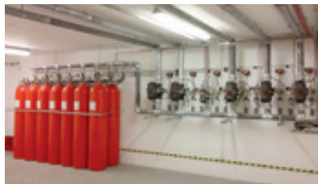
Pomieszczenie techniczne ze środkami gaśniczymi (gaz)
